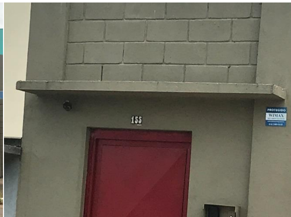
Figura II 56 - Av. Londres, nº 155, em Arujá, em 16/02/18, empreendimento não apto.
