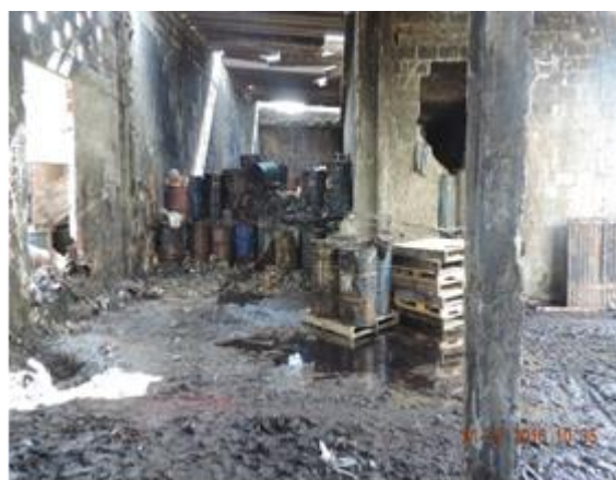
Figura 3 – Recipientes contendo resíduos armazenados em área interna, conforme constatado em 2015.
