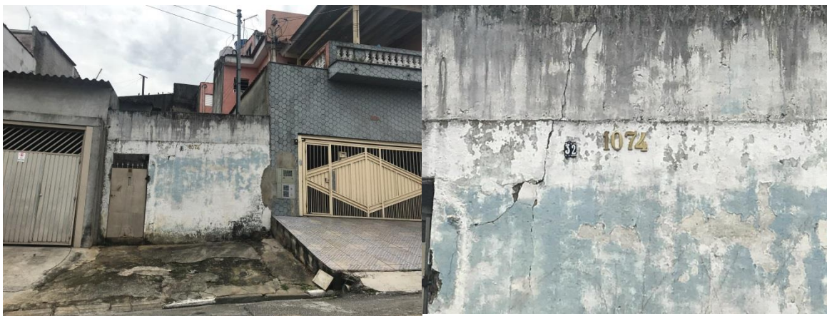
Figura II 46 - Rua Trevo de Santa Maria, n° 32, em São Paulo, em 19/01/18, empreendimento não apto.
