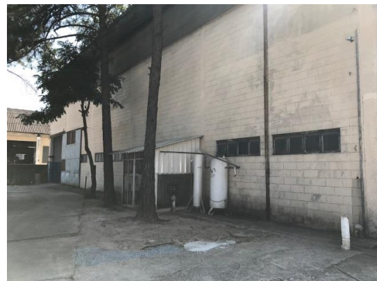
Figura II 19 - Rua Rio de Janeiro 151, em Diadema, em 16/11/17, empreendimento não apto.
