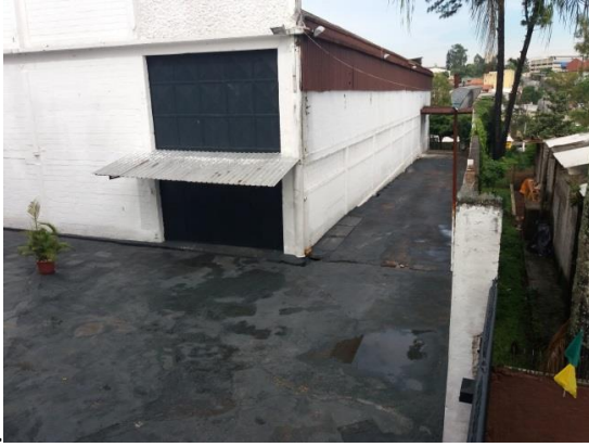
Figura II 13 - Rua Senador Manoel Cordeiro Vilassa, 945, em São Bernardo do Campo, em 26/10/17, empreendimento não apto.
