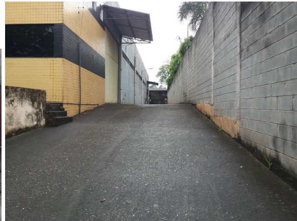
Figura II 17 - Estrada Particular Yae Massumoto, 193, em São Bernardo do Campo, em 26/10/17, empreendimento não apto.
