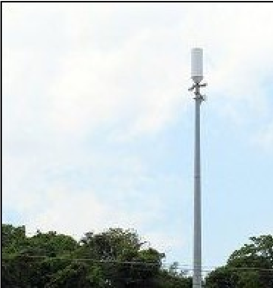
Imagem 9 - Equipamentos instalados em Postes (Pole sites) que simulam postes de iluminação
