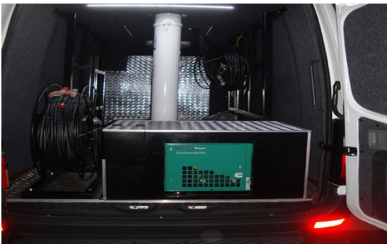
Imagem 8 – Equipamento de ERB Móvel montado em automóvel adaptado (furgão)
