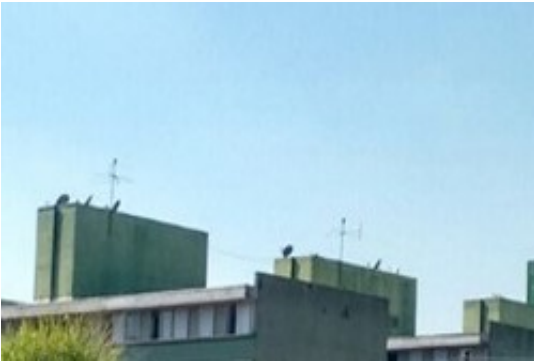
Imagem 11 - Equipamentos instalados em ROOF TOP – mimetizados com a arquitetura existente
