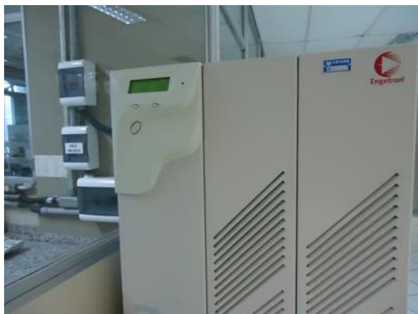
Foto 3. Rede elétrica modernizada e nobreak do LC-MS/MS
