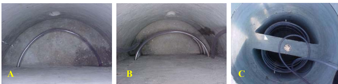
Figura 8. Vista interna do biodigestor indiano utilizado no experimento com detalhes da instalação do trocador de calor.
