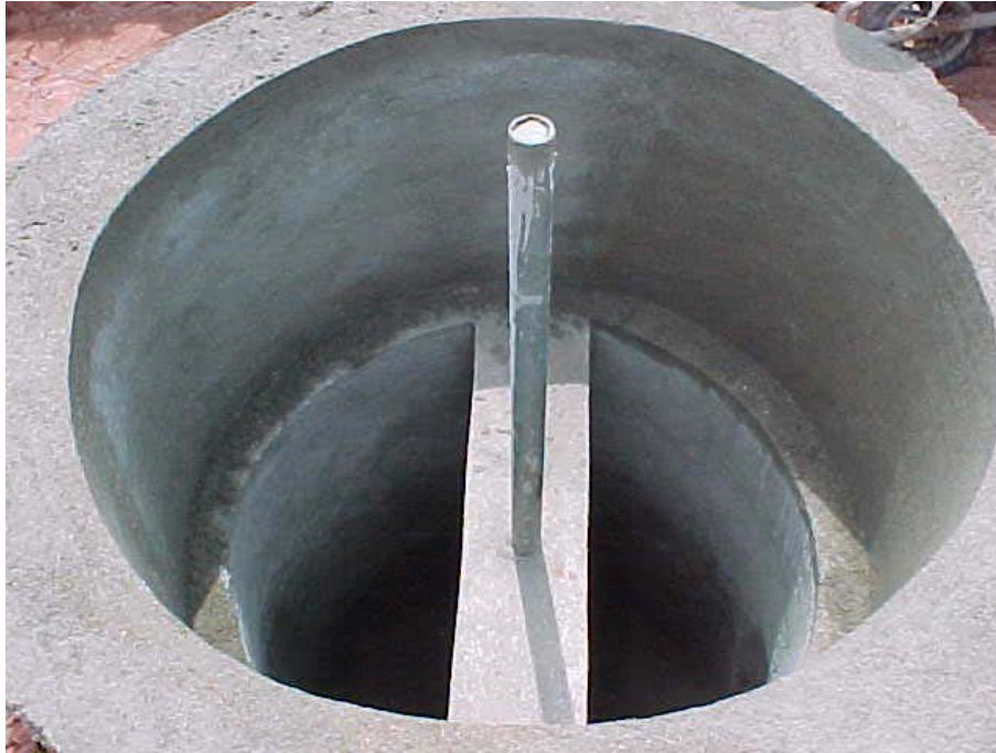
Figura 5. Vista do interior do biodigestor, utilizado no experimento.
