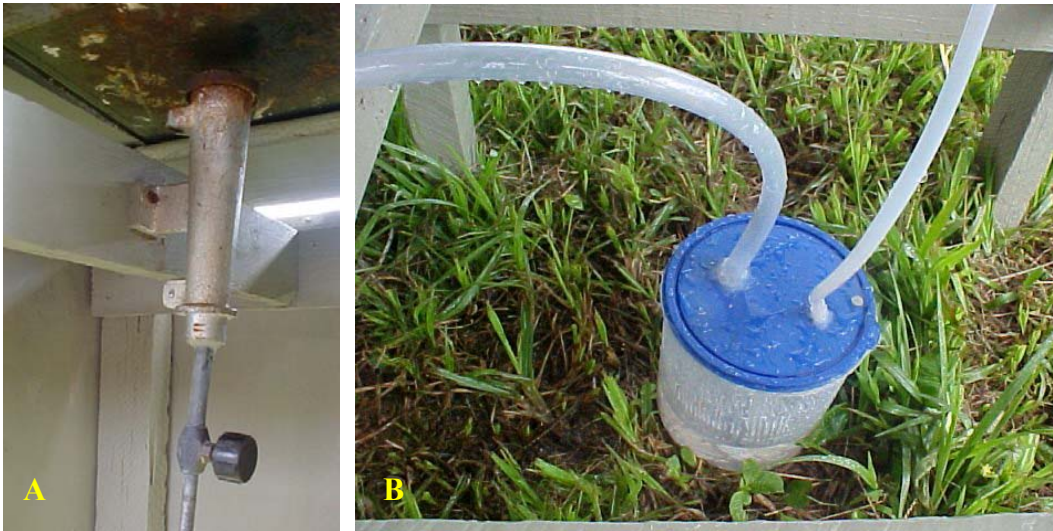
Figura 10. Detalhe do queimador (A) adaptado para o aquecimento da água e do corta-fogo (dispositivo de segurança) (B), adotados no experimento.
