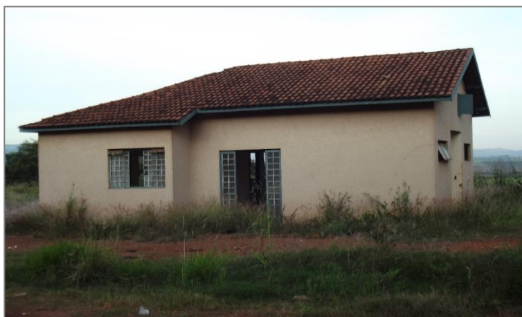
Figura 94 – Edifício de administração abandonado e sucateado – 2019
