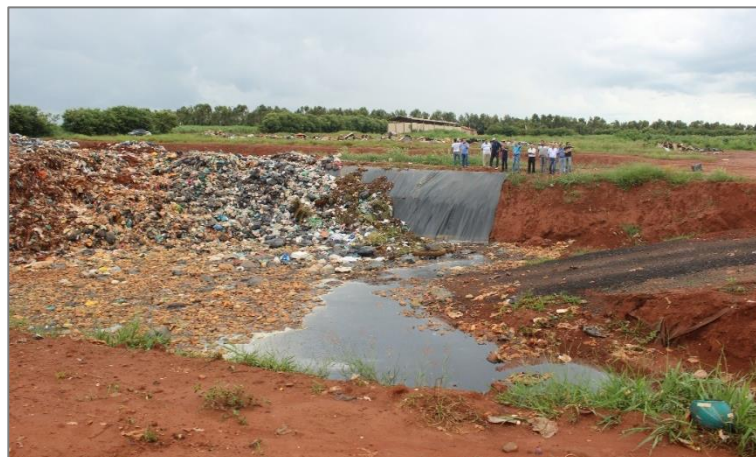
Figura 87 – Vala irregular (parcialmente sem impermeabilização) – 2017
