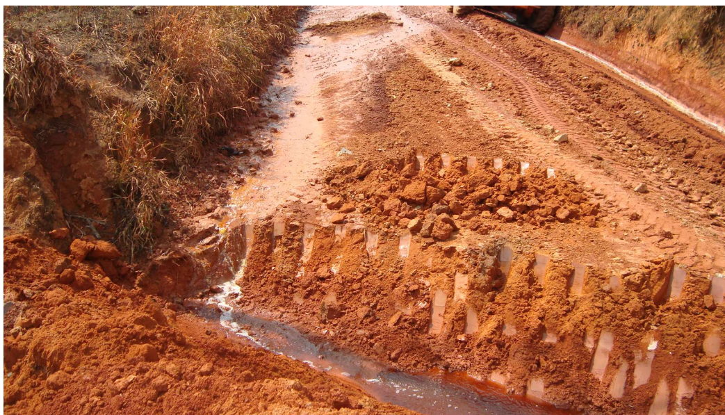
Imagem 3 – Canaleta de Sacrifício
