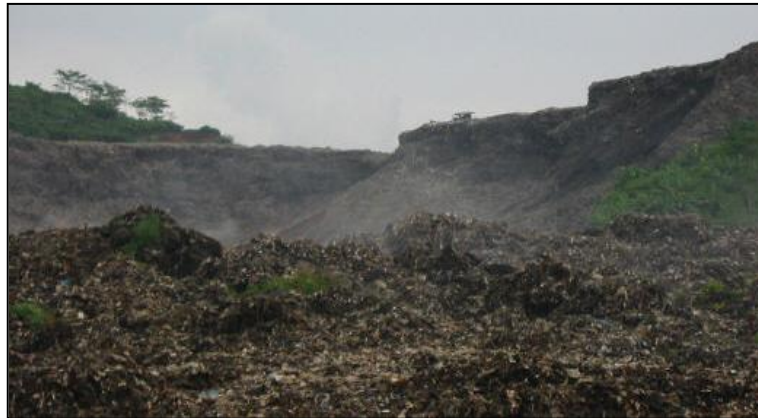
Figura 3.4: Aterro de Leuwigajah após ruptura (KÖLSCH)
