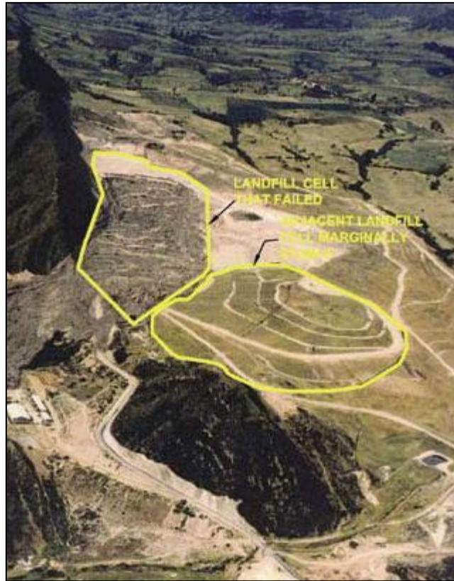
Figura 3.6 – Ruptura do aterro de Bogotá (Colombia) em 1997 (HENDRON, 2006)
