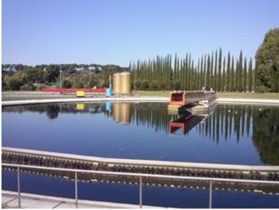
Imagem 12: Tanque de decantação, ETE Roma Nord, setembro de 2014.
