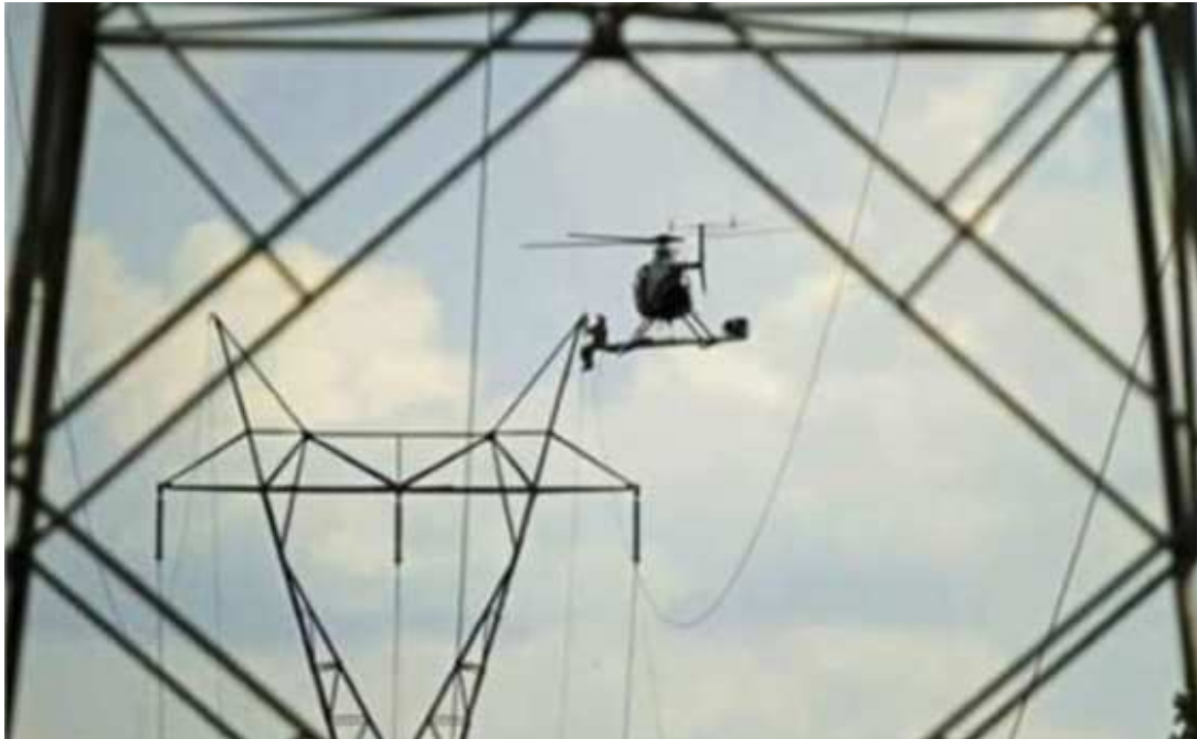
Figura 9 – Lançamento de cabos com o auxílio de helicóptero. Fonte: Arquivo da CETESB.
