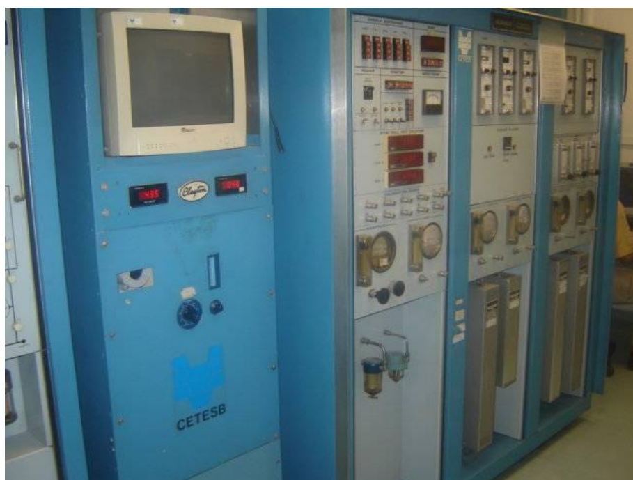
Figura 13: Foto da sala dos analisadores de gases
