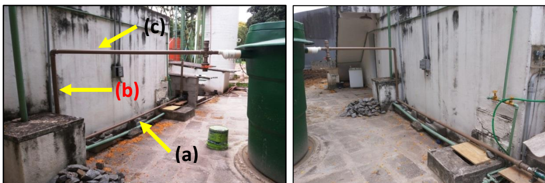
Figura 7. Tubulação de recalque
