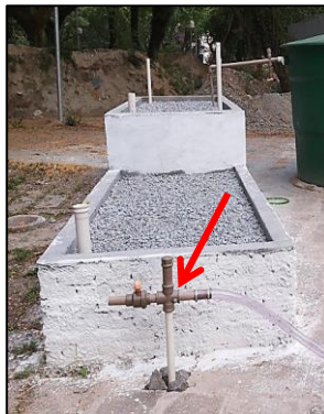
Figura 18. Trecho aparente do dispositivo de controle do nível da lâmina de esgoto no meio filtrante da câmara de fluxo horizontal
