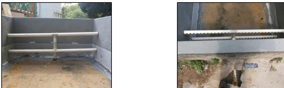
Figura 15. Sistema de coleta de esgoto tratado da câmara de fluxo horizontal
